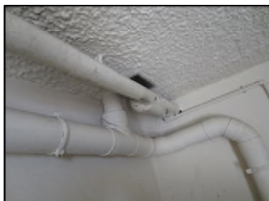
Photo N° 566 ECH-N°2 CALORIFUGEAGE PARKING Conduits de fluide Laine minérale + enveloppe bituminée
